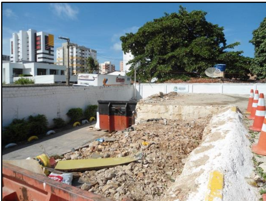
Figura 57. Registro fotográfico do Eco-ponto Pajuçara – local para RCC. Fonte: registro fotográfico dos autores.
