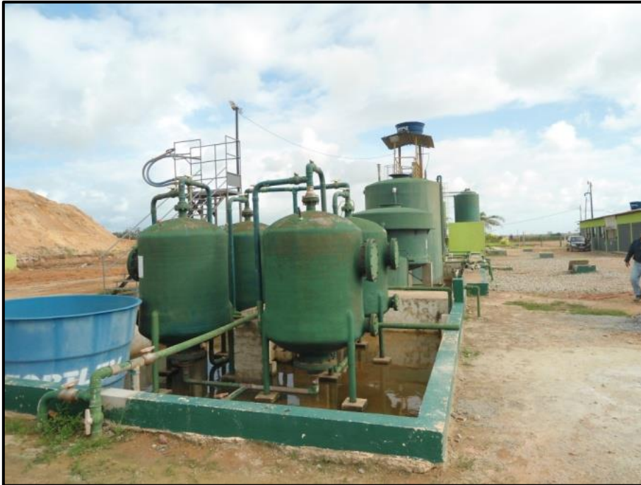
Figura 27. Registro fotográfico do sistema físico-químico. Fonte: registro fotográfico dos autores.
