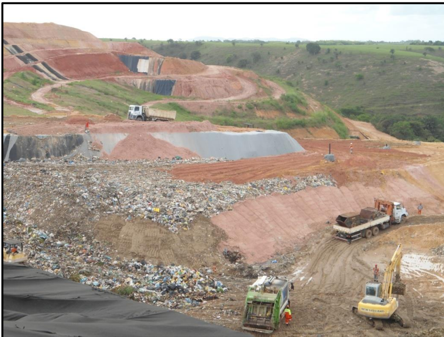
Figura 24. Vista da frente de serviço do aterro sanitário - CTRA/MA. Fonte: registro fotográfico dos autores.
