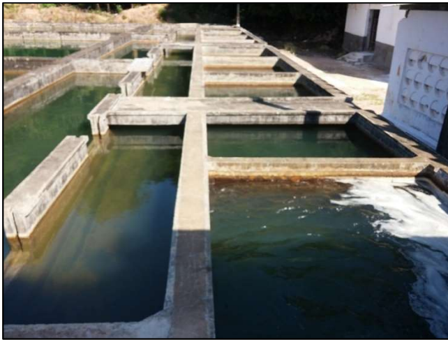
Figura 61. Tanques de coagulação e floculação. Fonte: MJ Engenharia.
