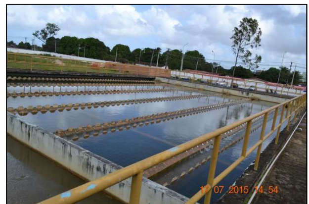
Figura 60. Decantadores. Fonte: MJ Engenharia.
