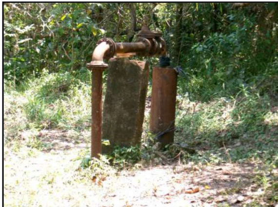
Figura 45. Poço de captação da CASAL
