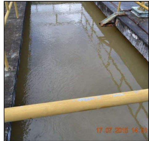
Figura 58. Câmara de Floculação. Fonte: MJ Engenharia.
