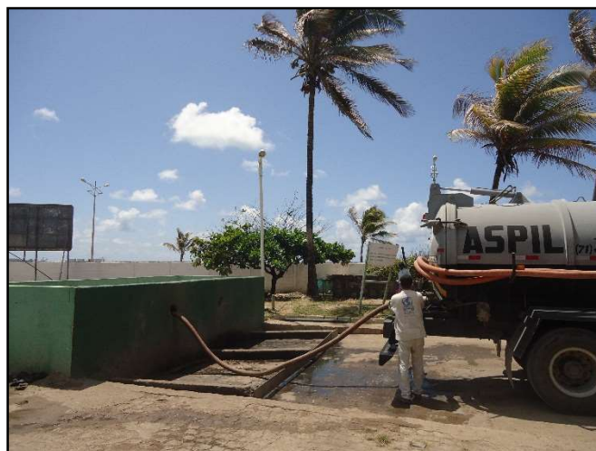
Figura 75. Recebimento de Efluentes de Fossa na Câmara de chegada da ETE. Fonte: MJ Engenharia
