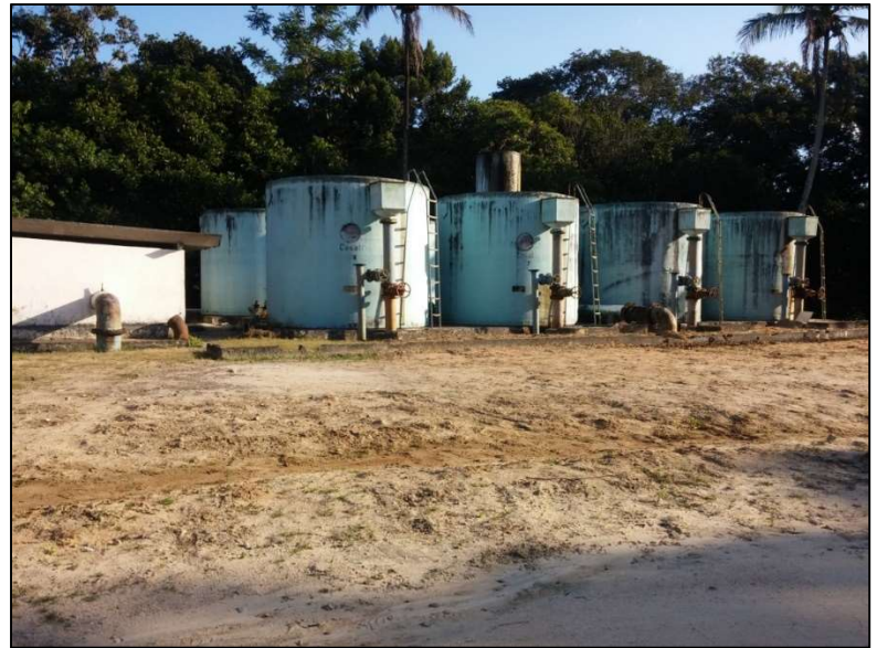
Figura 64. Vista externa dos filtros da ETA. Fonte: MJ Engenharia.
