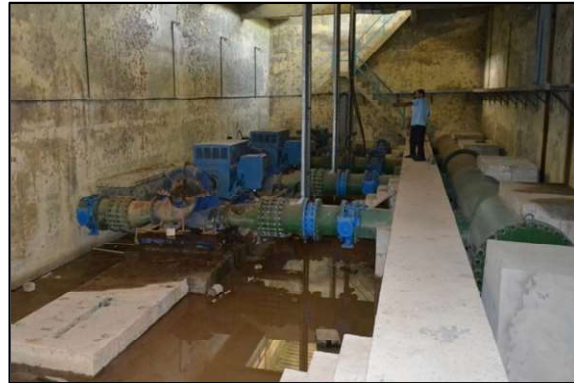
Figura 52. Bombas da Estação de Bombeamento de Água Bruta. Fonte: MJ Engenharia.
