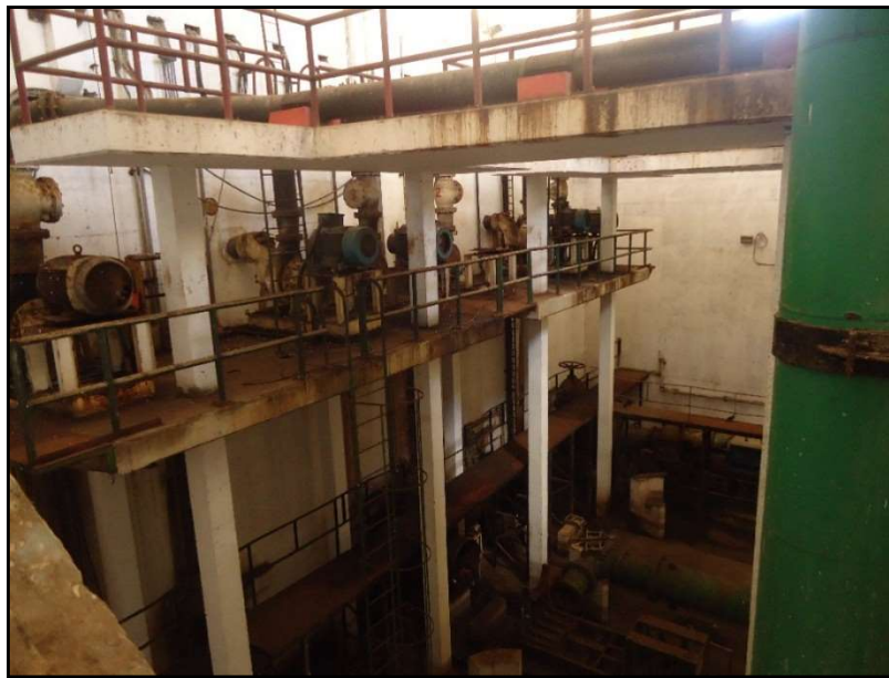
Figura 78. Visão Geral do interior da EEE Emissário Submarino. Fonte: MJ Engenharia.
