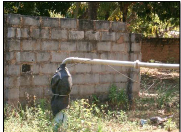
Figura 46. Poço de captação da CASAL
