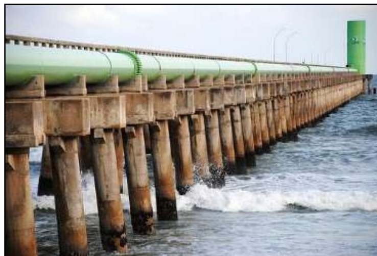
Figura 89. Emissário Submarino de Maceió – trecho de tubulação aérea. Fonte: http://www.tribunahoje.com/vgmídia/imagens/48720_ext_arquivo.jpg (acesso em 05/09/2015)
