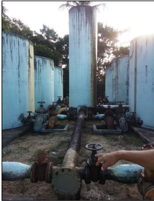
Figura 63. Vista do centro da ETA. Fonte: MJ Engenharia.
