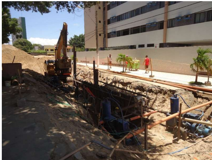
Figura 91. Obras de ampliação da rede coletora de esgotos na bacia Sudeste. Fonte: MJ Engenharia
