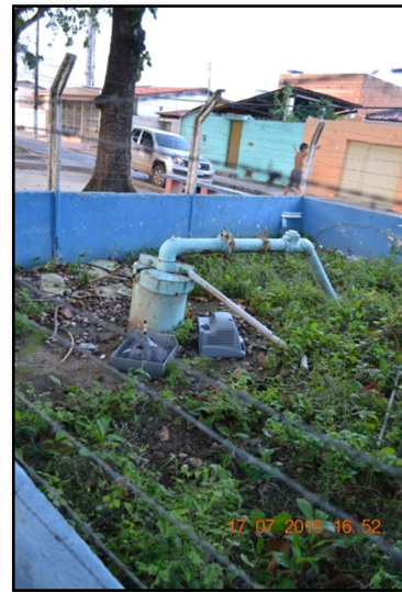
Figura 44. Poço de captação da CASAL Benedito Bentes.
