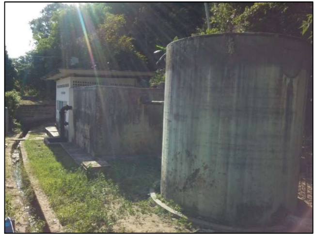
Figura 68. ETA Fernão Velho. Fonte: MJ Engenharia.
