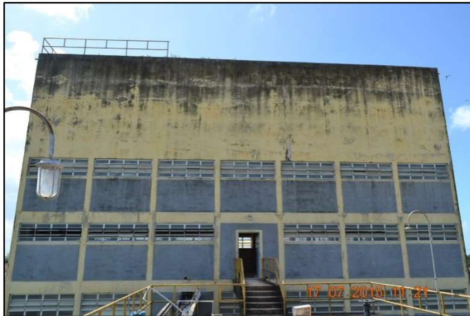
Figura 57. Reservatório de água bruta da ETA. Fonte: MJ Engenharia.
