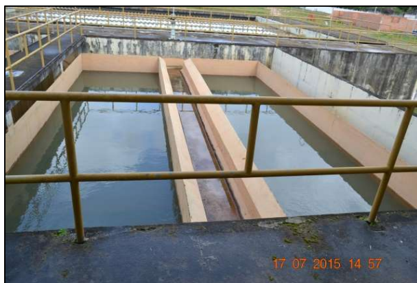
Figura 59. Filtros da ETA Pratygy. Fonte: MJ Engenharia.
