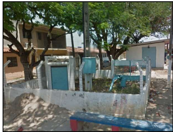
Figura 50. Poço de captação da CASAL
