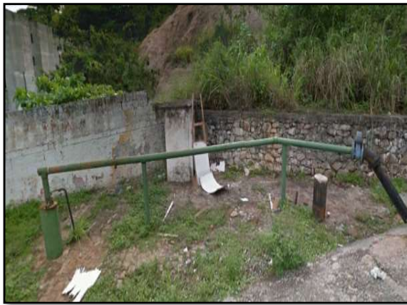
Figura 49. Poço de captação da CASAL
