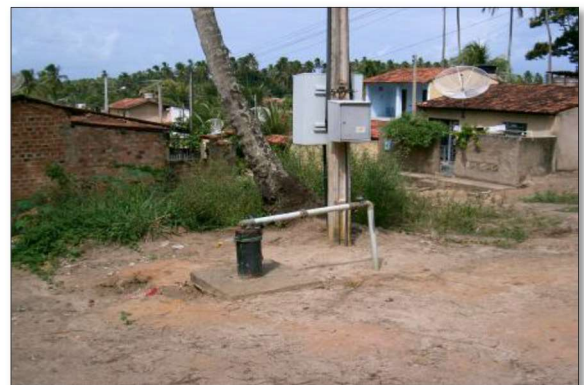
Figura 42. Poço de captação da CASAL
