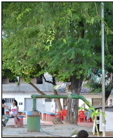
Figura 43. Poço de captação da CASAL Benedito Bentes.
