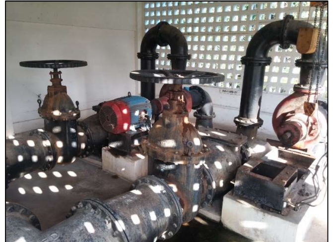
Figura 56. Estação Elevatória de Água Bruta. Fonte: MJ Engenharia.
