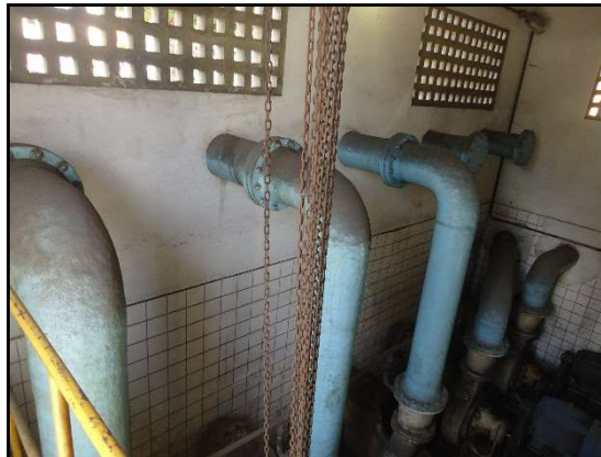
Figura 98. Detalhe das duas linhas de recalque diferentes da EEE – Praça 13 de Maio. Fonte: MJ Engenharia
