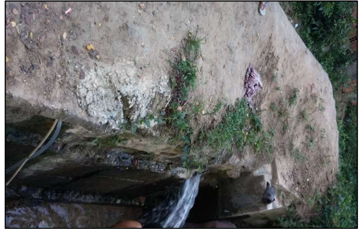
Figura 54. Furtos no Aqueduto Catolé-Cardoso. Fonte: MJ Engenharia.
