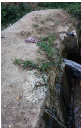
Figura 5: Vazamentos no aqueduto Catolé. Fonte: MJ Engenharia.
