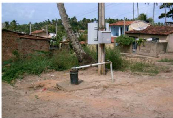
Figura 6: Exemplo de poço de captação da CASAL. Fonte: MJ Engenharia.
