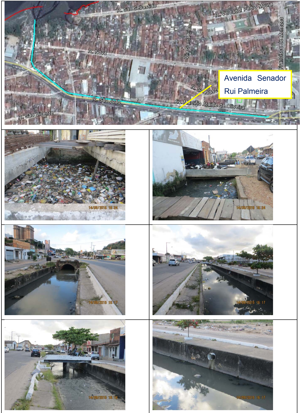
Figura 25: Avenida Senador Rui Palmeira– Canal aberto, paredes revestidas em concreto armado, com extensão de 725 m.
