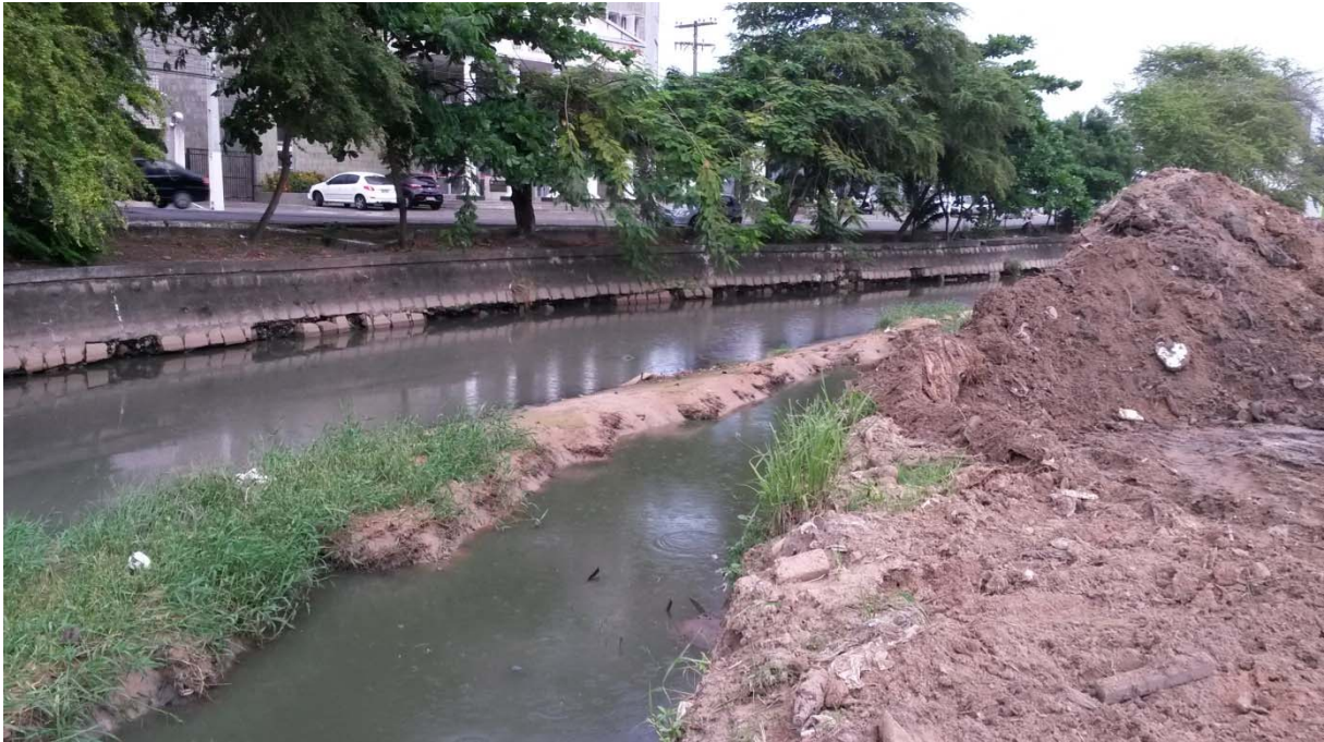
Figura 20: Execução de desassoreamento do Riacho Reginaldo no trecho de jusante, com deposição de material na margem direita. Fonte: Autor em julho/2015)
