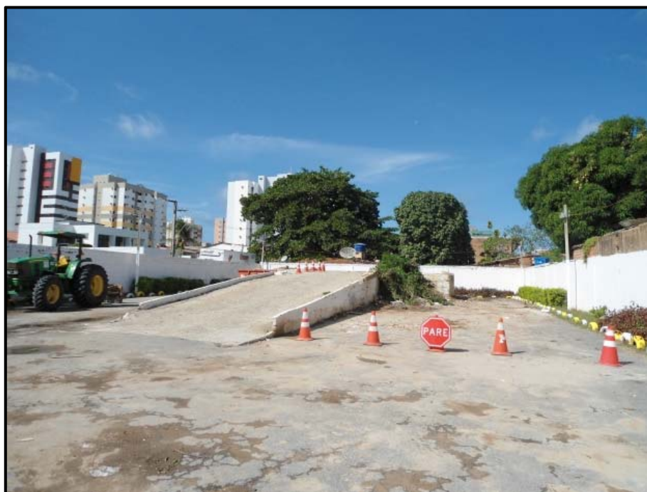
Figura 57. Registro fotográfico do Ecoporto Pajuçara – vista geral.
