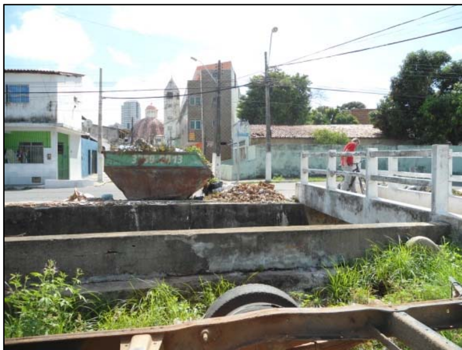
Figura 17. Caixa estacionária localizada em um dos canais revestidos de Maceió. Fonte: registro fotográfico dos autores.
