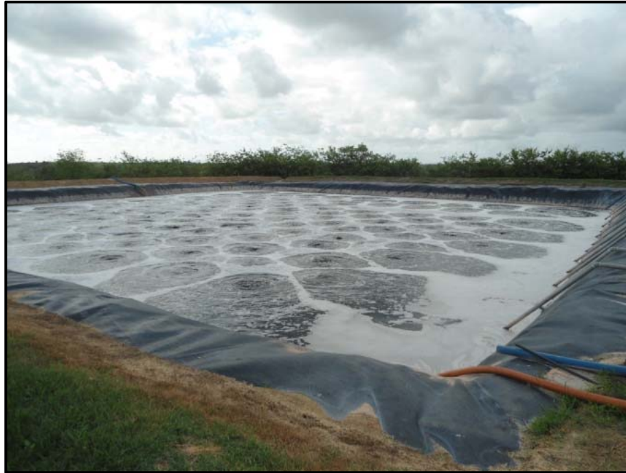
Figura 31. Registro fotográfico da lagoa aerada.
