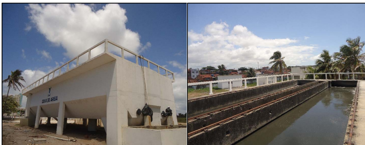
Figuras 33 e 34. Vistas da caixa de areia da ETE – Disposição Oceânica
