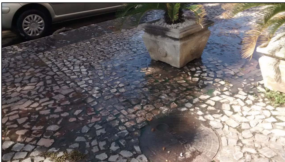
Figura 40. Transbordamento de esgoto na Bacia da Pajuçara
