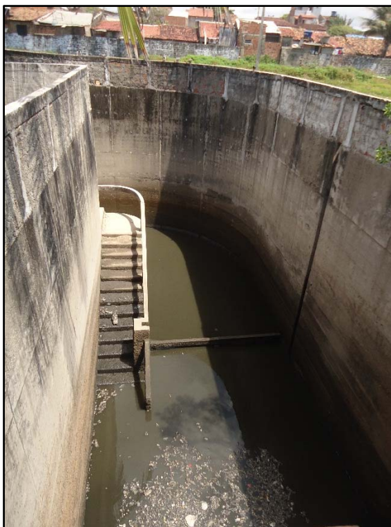
Figura 22. Câmara de chegada da ETE – Disposição Oceânica
