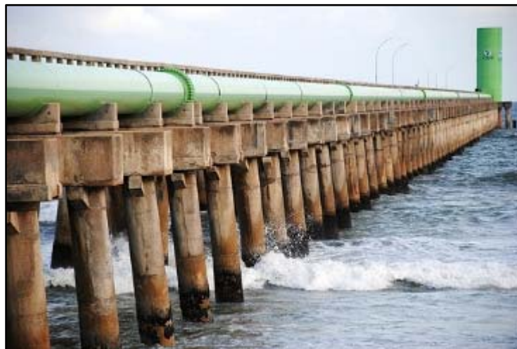
Figura 39. Emissário Submarinho de Maceió – trecho de tubulação aérea
