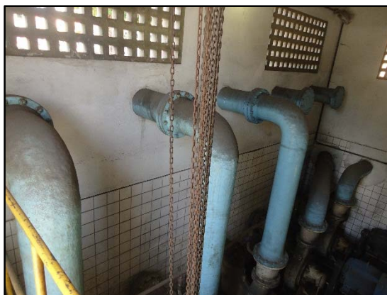
Figura 50. Detalhe das duas linhas de recalque diferentes da EEE – Praça 13 de Maio.
