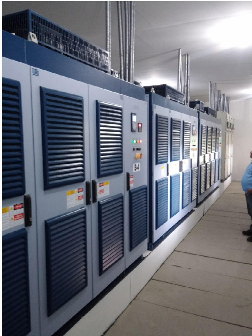
Figura 29. Inversores de frequência. Fonte: MJ Engenharia.
