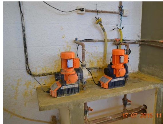
Figura 34. Bombas de adição de sulfato de alumínio. Fonte: MJ Engenharia.
