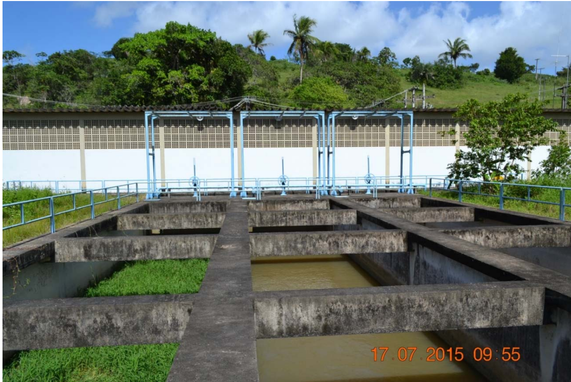
Figura 25. Entrada da captação. Detalhe para o acumulo de vegetação sobrenadante na esquerda. Fonte: MJ Engenharia.
