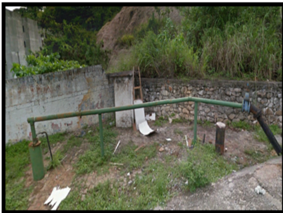
Figura 75. Poço de captação da CASAL
