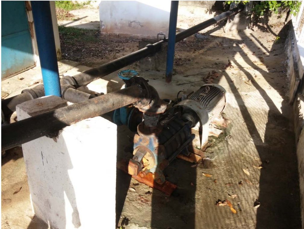
Figura 44. Estação elevatório do bairro Rio Novo, ao fundo o a casa onde fica o dosador de cloro. Fonte: MJ Engenharia.
