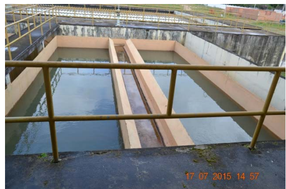
Figura 38. Filtros. Fonte: MJ Engenharia.
