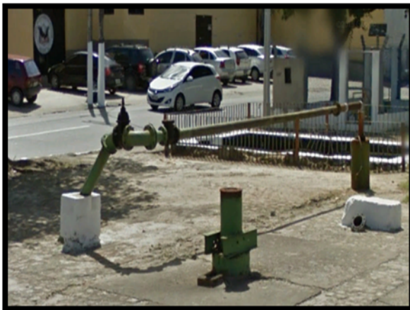
Figura 73. Poço de captação da CASAL
