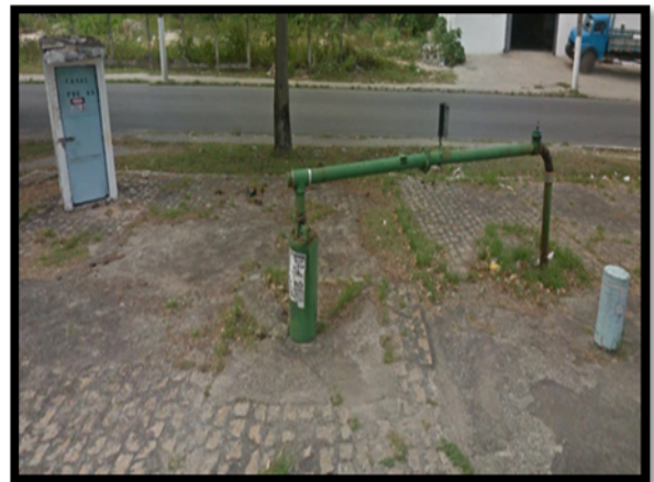
Figura 74. Poço de captação da CASAL
