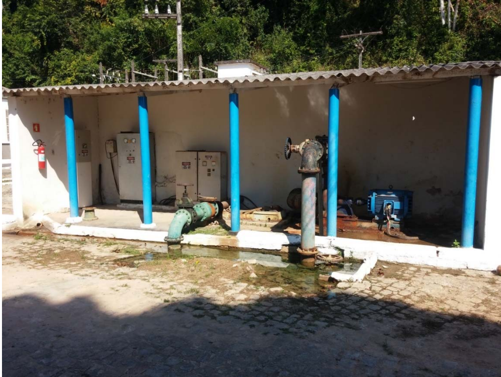
Figura 57. Estação elevatória de água tratada que recalca para o reservatório R8. Fonte MJ Engenharia.
