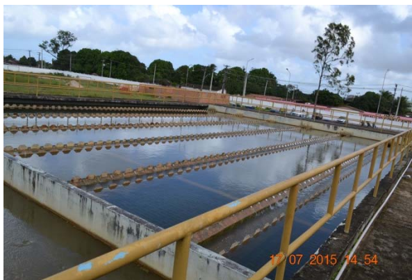
Figura 36. Decantadores. Fonte: MJ Engenharia.
