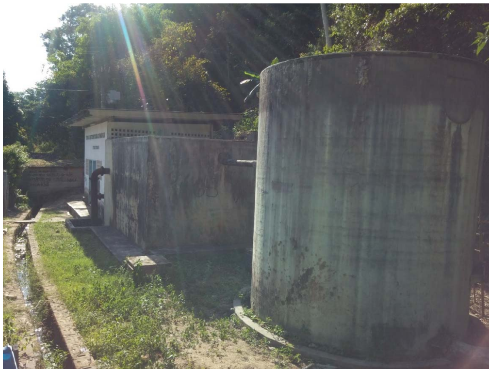
Figura 88. ETA Fernão Velho. Fonte: MJ Engenharia.
