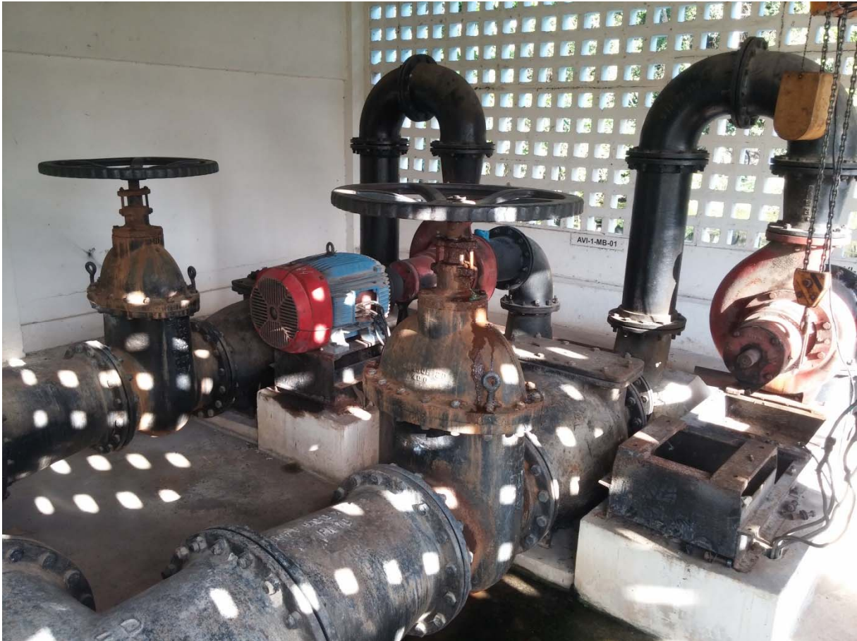
Figura 61. Estação Elevatória de Água Bruta do sistema aviação. Fonte MJ Engenharia.
