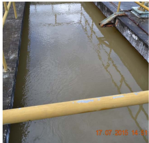
Figura 37. Câmara de Floculação. Fonte: MJ Engenharia.
