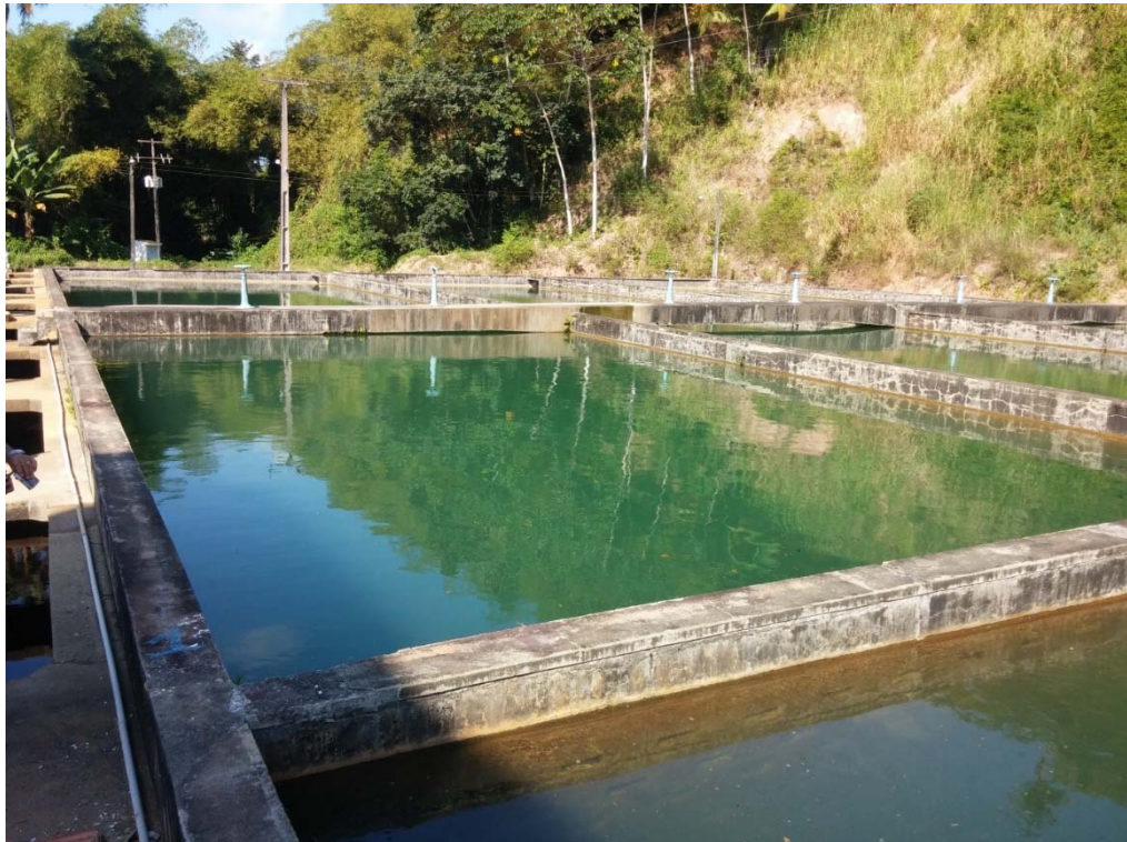
Figura 52. Tanques de decantação. Fonte: MJ Engenharia.
