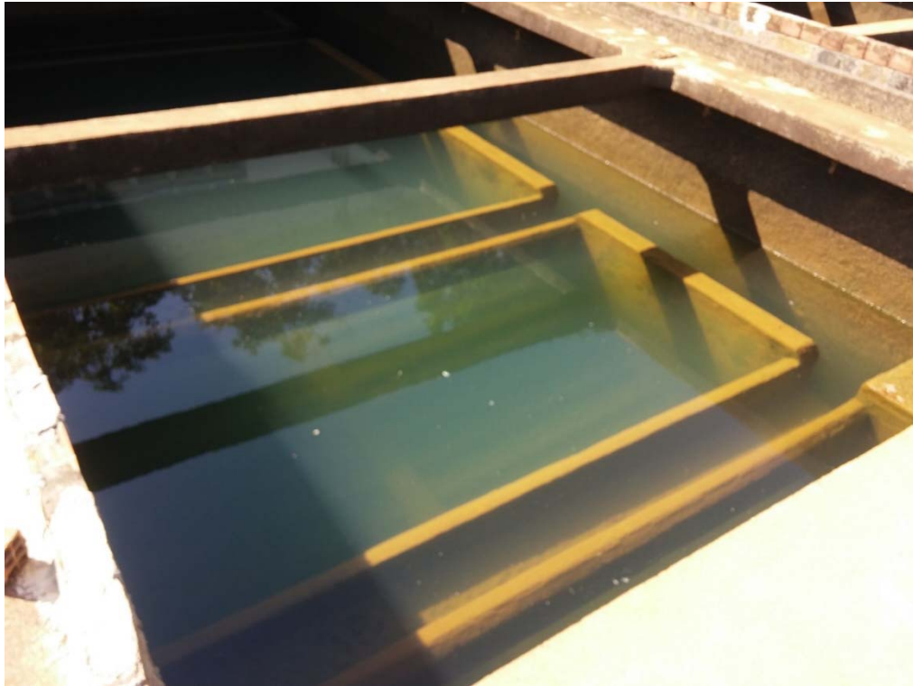
Figura 53. Filtros, sem o material filtrante. Fonte: MJ Engenharia
