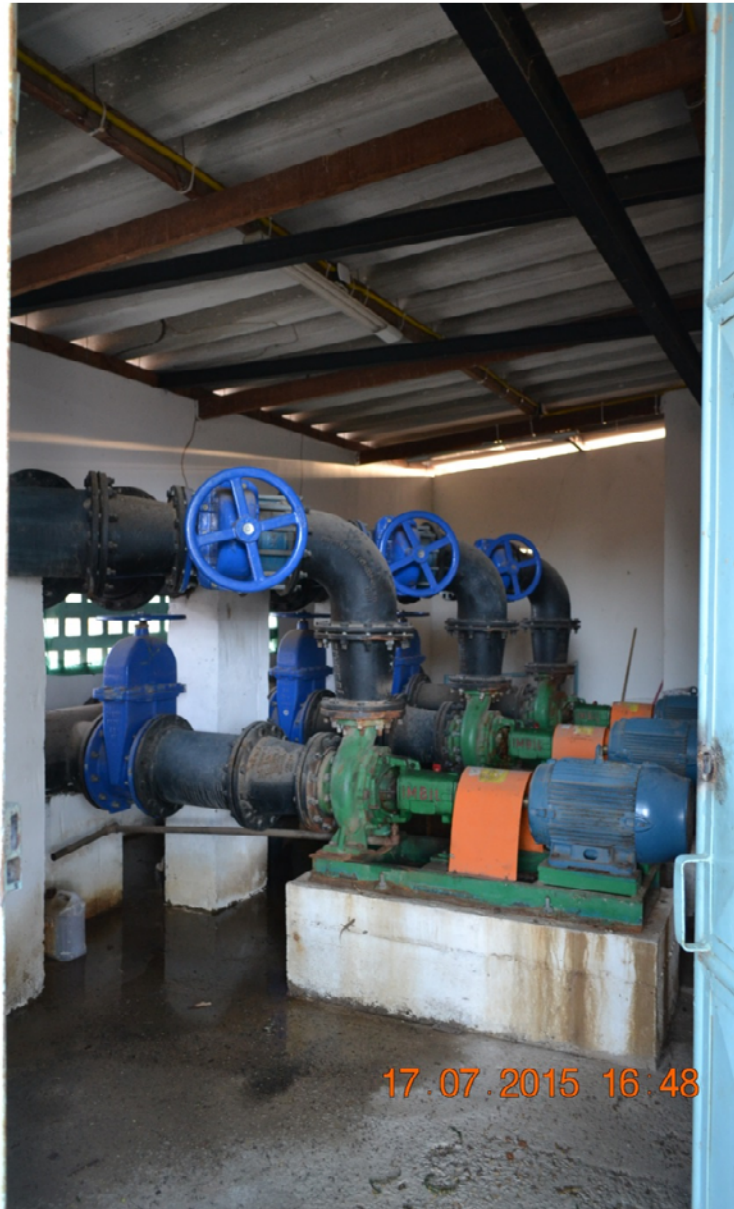
Figura 39. Booster. Fonte: MJ Engenharia.
