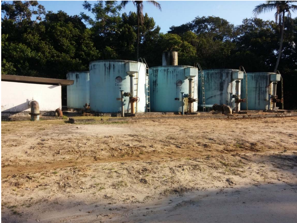
Figura 63. Vista geral da ETA Aviação. Fonte MJ Engenharia.
