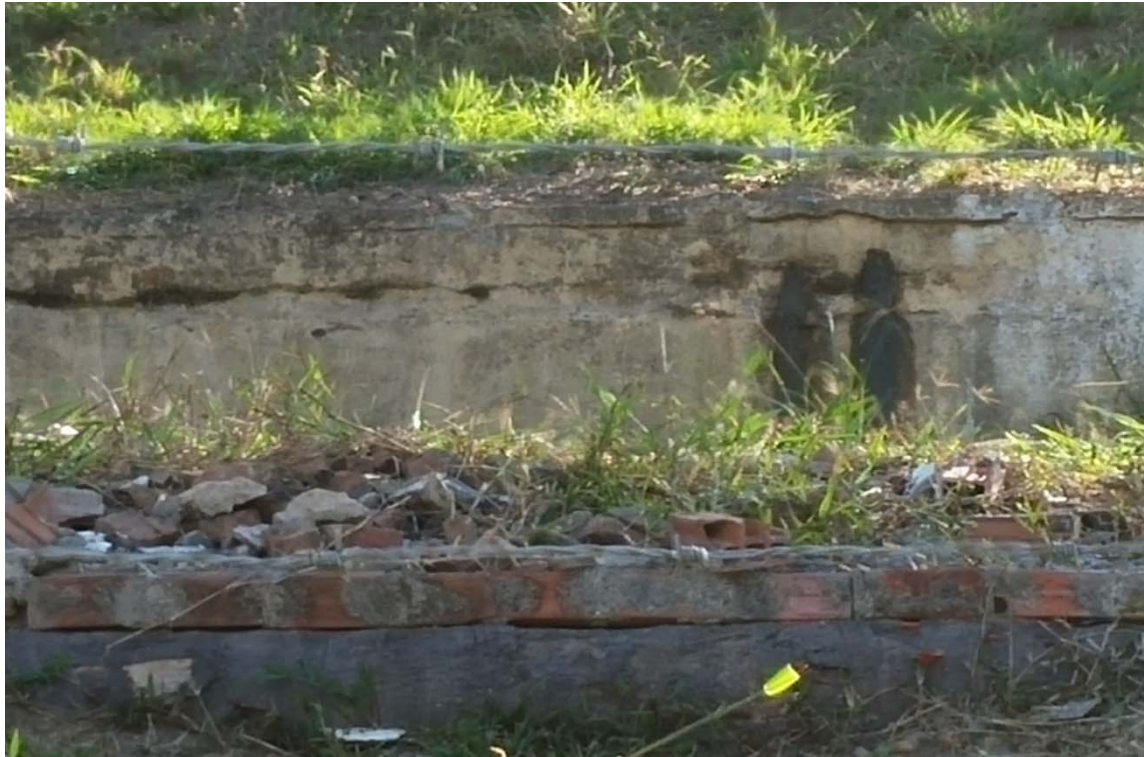
Figura 45. Detalhe do aqueduto com manchas escuras, indicando vazamentos e a vegetação crescendo sobre a estrutura. Fonte: MJ Engenharia.
