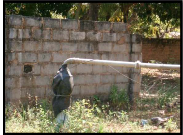
Figura 72. Poço de captação da CASAL
