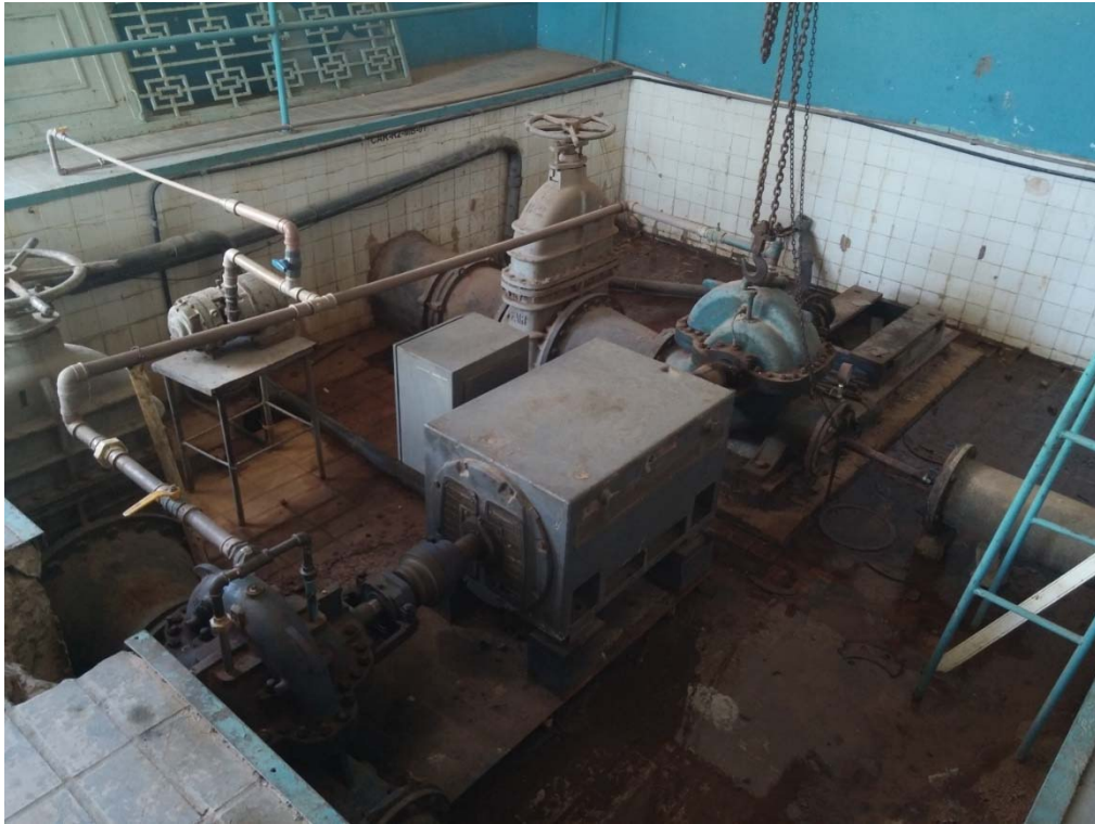
Figura 58. Estação elevatória localizada na ETA Cardoso que recalca para os reservatórios R3A e R2A. Fonte: MJ Engenharia.
