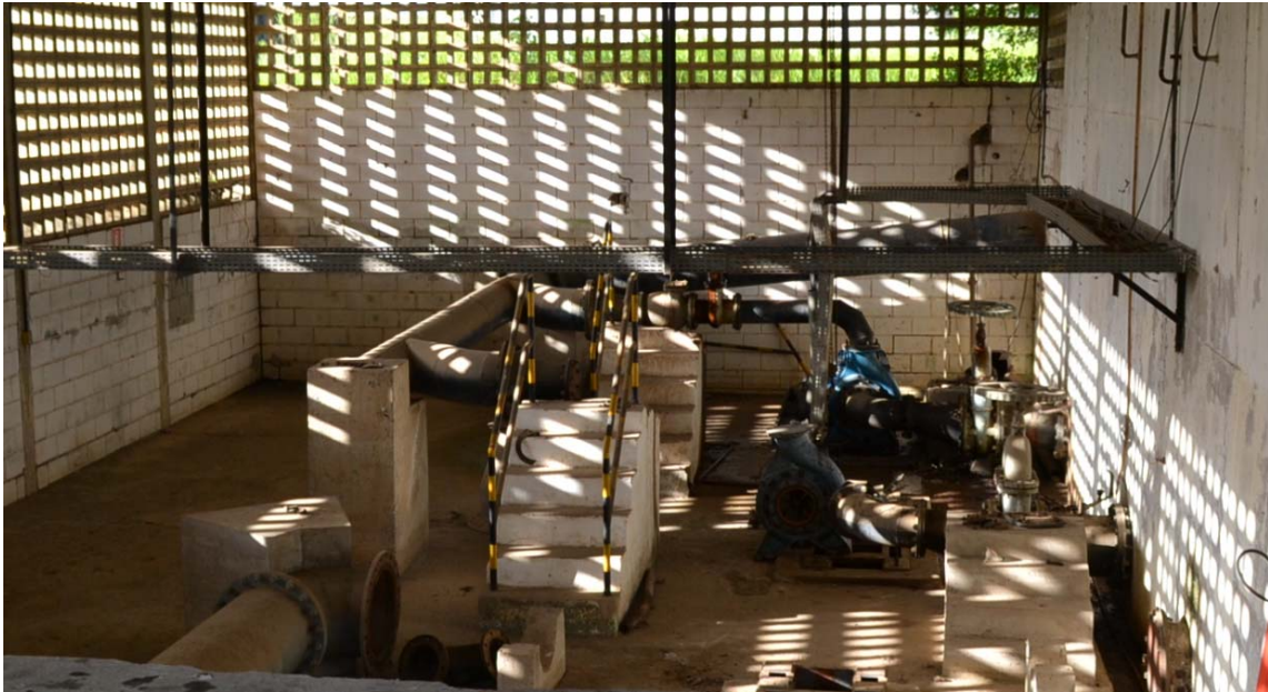
Figura 40. EEAT Benedito Bentes, detalhe para a bomba na parte da frente da imagem sem o seu motor, que está em manutenção. Fonte: MJ Engenharia.
