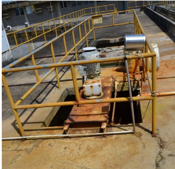
Figura 35. Câmara de Mistura. Fonte: MJ Engenharia.
