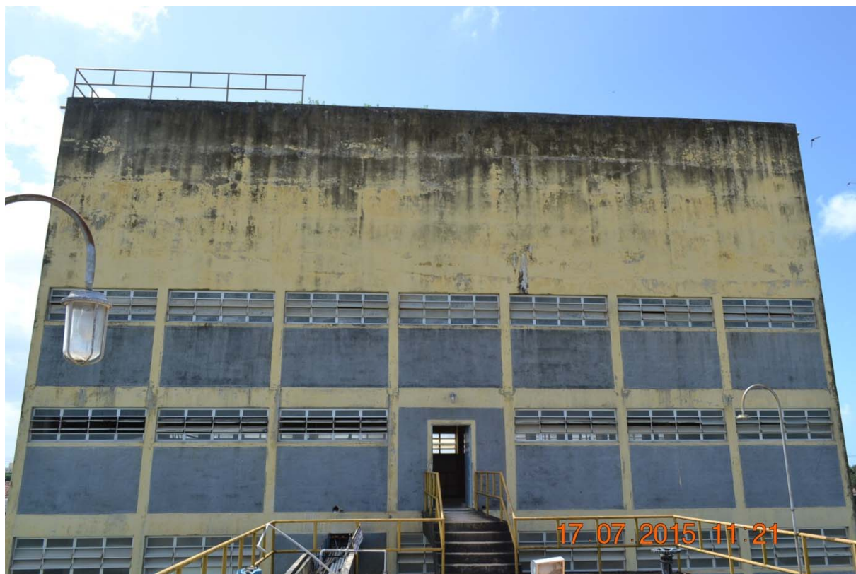
Figura 31. Reservatório de água bruta da ETA Josué Palmeira do Sistema Produtor do Rio Pratagy. Fonte: MJ Engenharia.
