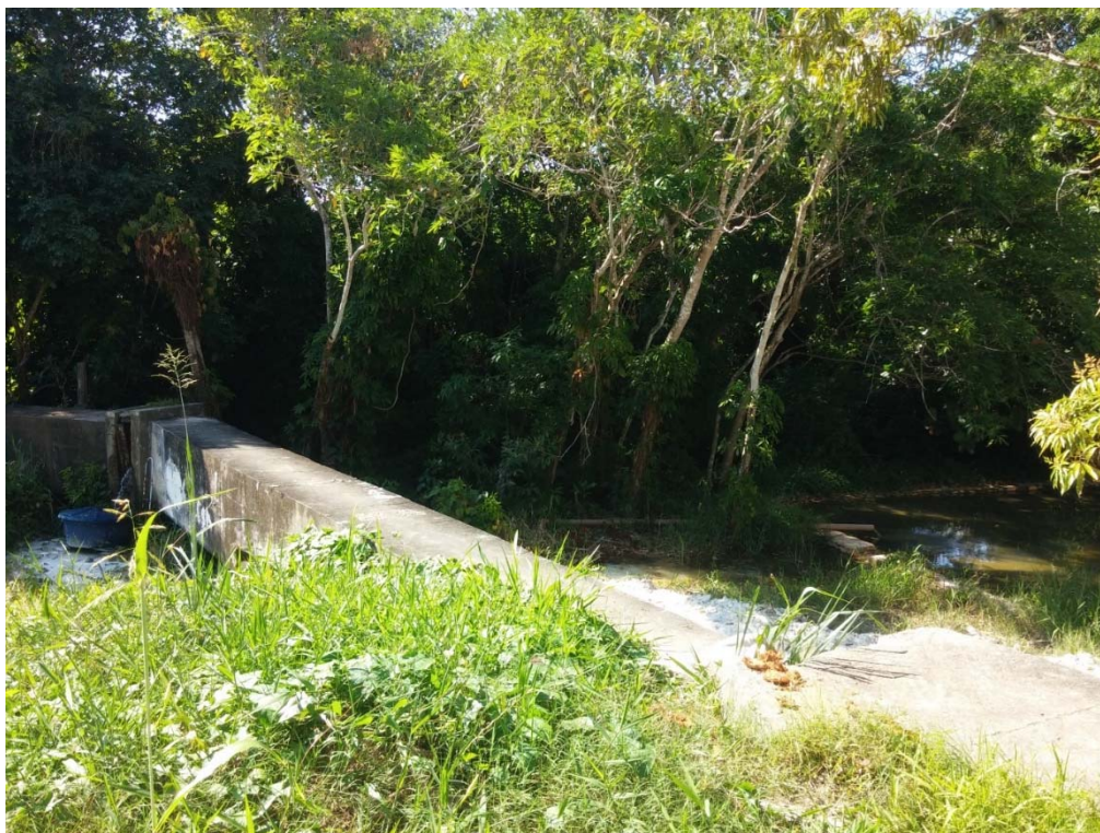
Figura 49. Sistema improvisado de aproveitamento de perdas. Fonte MJ Engenharia.
