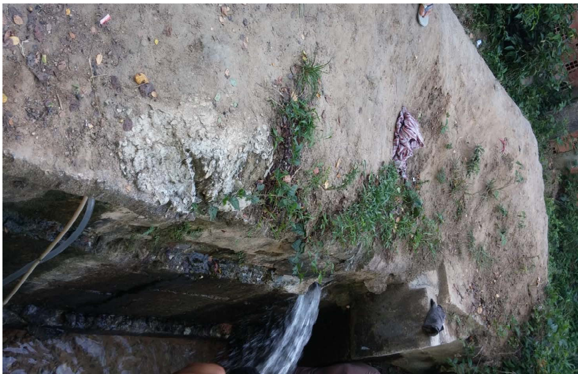
Figura 46. Furto de água do aqueduto. Orifício e pequeno diâmetro para a retirada de água através de mangueiras e de grande diâmetro usado para recreação. Foto tirada no bairro Fernão Velho. Fonte: MJ Engenharia.
