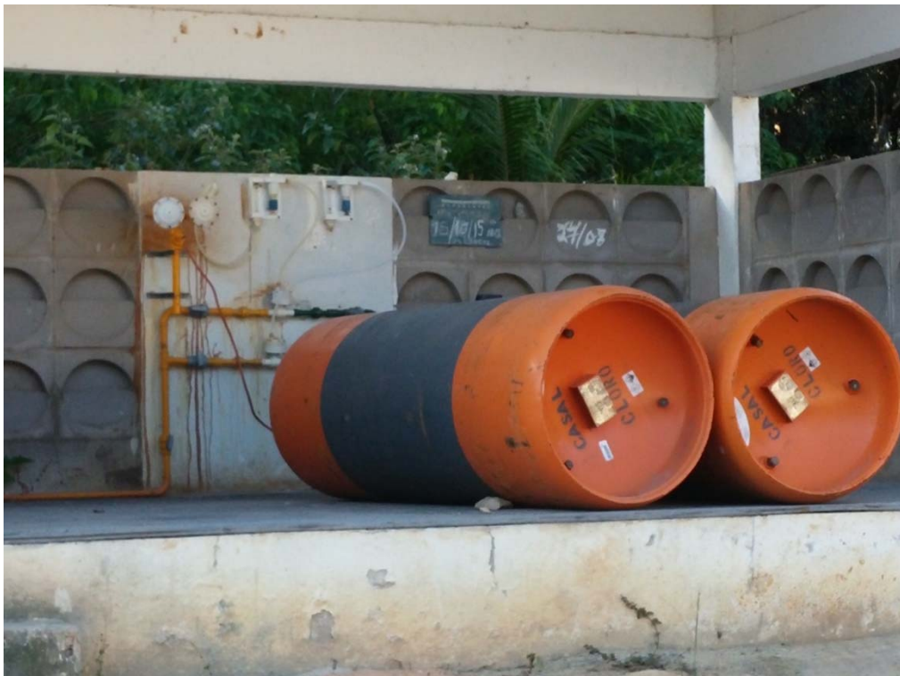
Figura 64. Tanques de cloro da ETA Aviação. Fonte MJ Engenharia.
