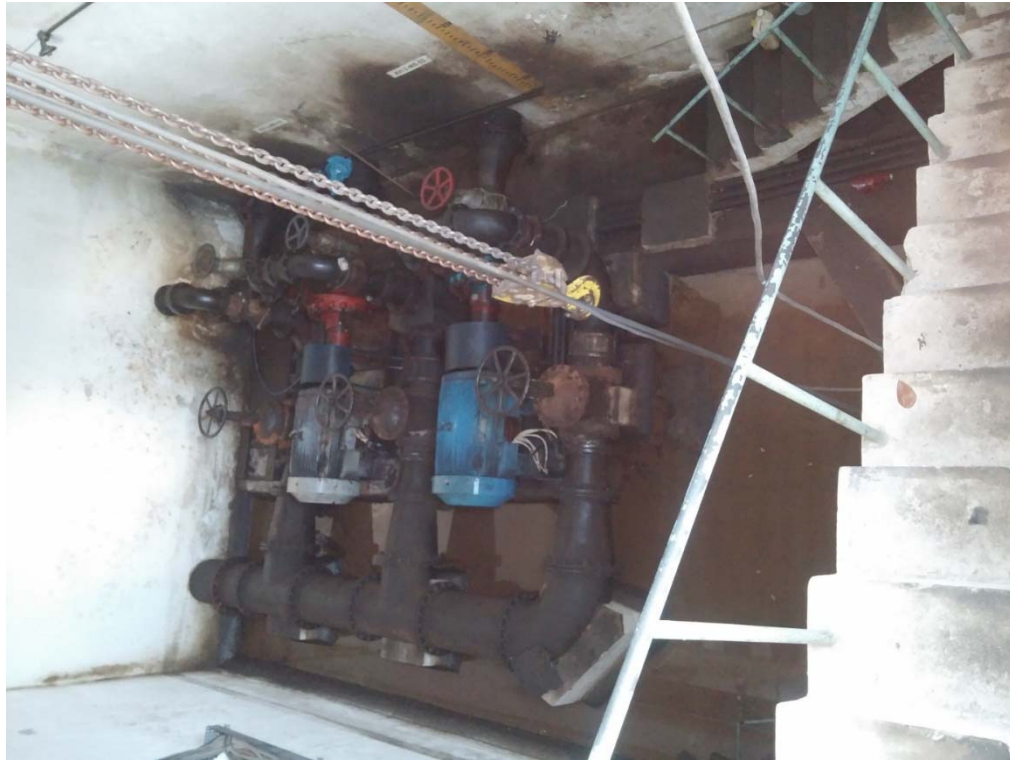
Figura 66. Estação Elevatória de Água Tratada da ETA Aviação. Fonte MJ Engenharia.
