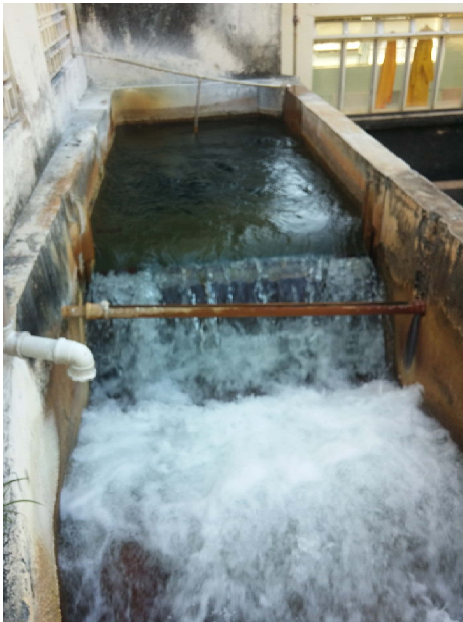
Figura 50. ETA Cardoso, chegada da água bruta. Fonte: MJ Engenharia.
