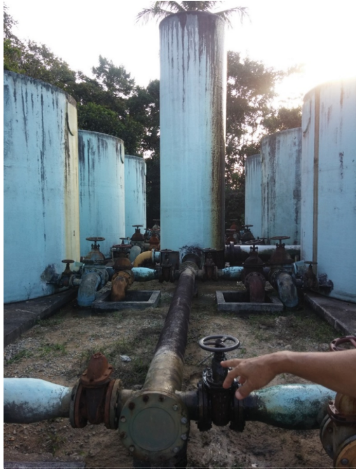
Figura 62. ETA Aviação. Ao centro a torre de chegada de água bruta e nas laterais os filtros ascendentes. Fonte MJ Engenharia.
