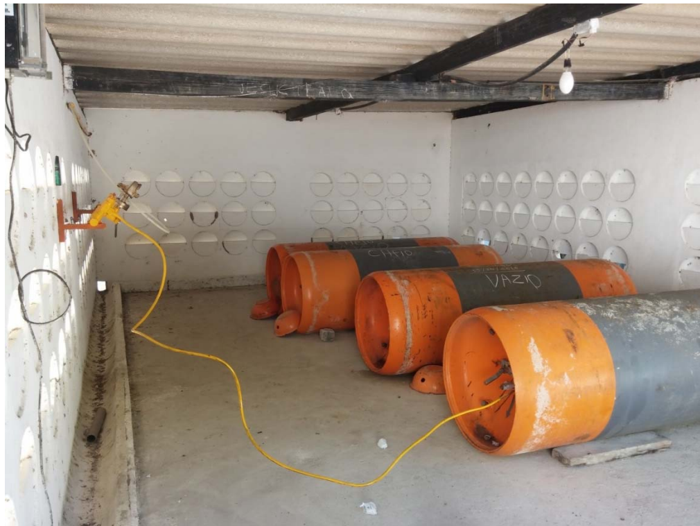
Figura 54. Tanques de Cloro. Fonte: MJ Engenharia.
