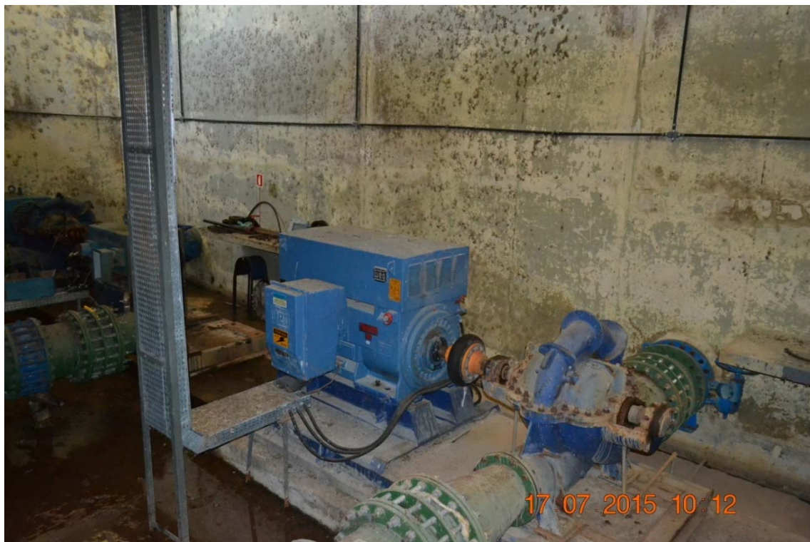
Figura 26. Uma das bombas da Estação Elevatória de Água Bruta do Sistema Pratagy, em detalhe. Fonte: MJ Engenharia.
