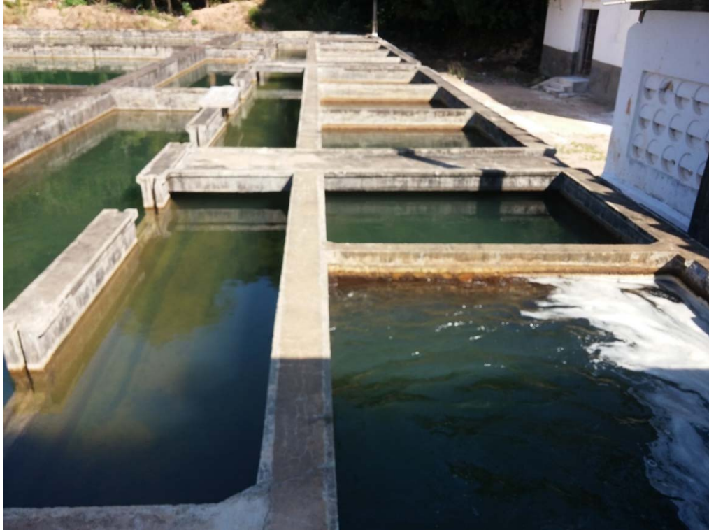
Figura 51. Tanques de coagulação e floculação. Fonte: MJ Engenharia.
