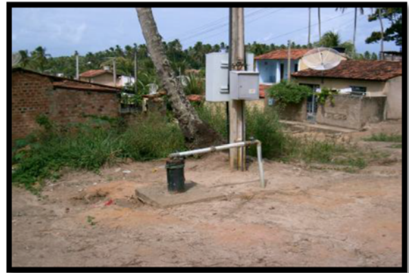
Figura 68. Poço de captação da CASAL
